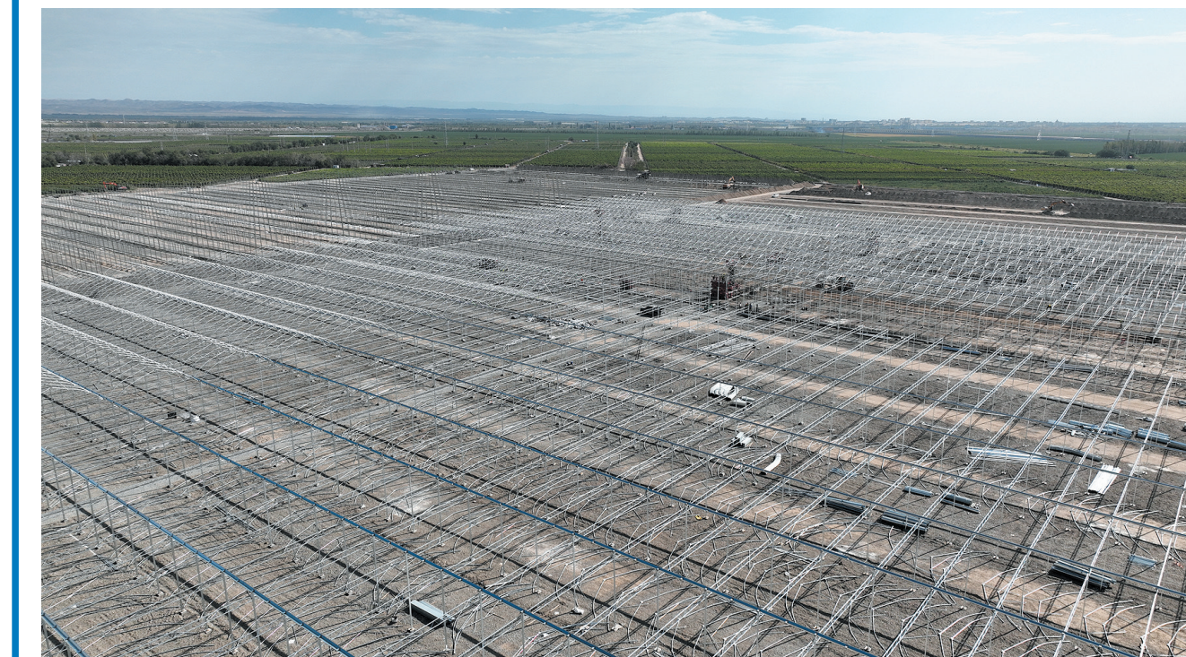
▲航拍的五师双河市20万平方米联栋智能温室大棚项目建设现场(摄于8月17日)。该项目总投资4.3亿元,占地面积480亩,将新建2栋双层充气薄膜密封智能温室,同时配套建设附属用房、水肥一体化车间、保鲜库等基础设施,预计今年9月建成。
