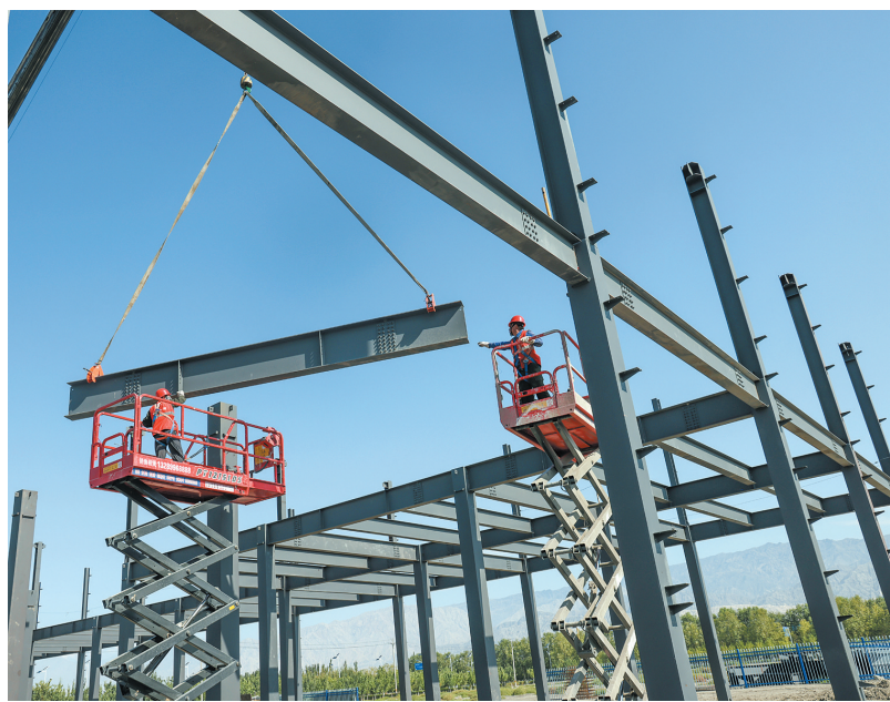
▲9月6日,在新疆振国塑料包装有限公司年产5000吨编织袋、集装袋生产线项目建设现场,工人进行生产车间钢结构组焊作业。该项目是二师二十九团招商引资项目,以为周边化工企业生产各类塑料制品为主业,建成后预计实现年产值5000万元,带动就业100人左右。冯波 摄
